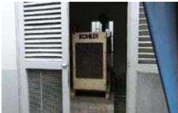
Fotografía 15: Grupo electrógeno Kohler Power System.
