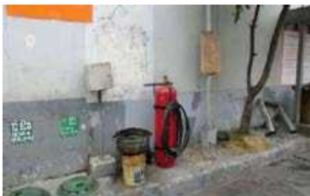
Fotografía 11: Extintores contra incendios en el área de descarga.
