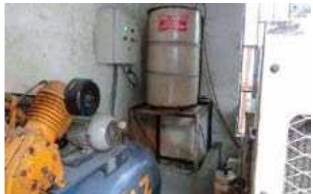
Fotografía 16: Cubeto de contención de combustible para el generador eléctrico.
