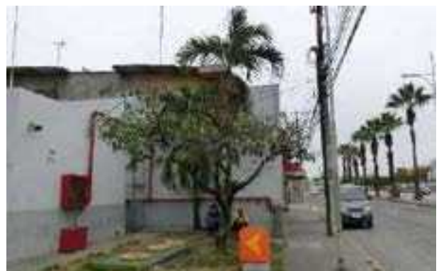
Fotografía 18: Boca contra incendios en la estación de servicio.
