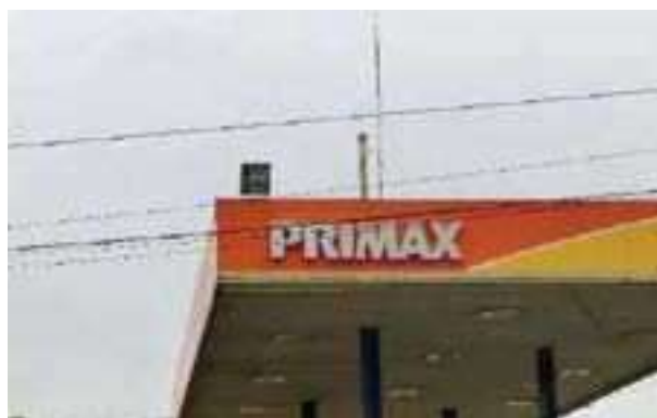
Fotografía 12: Las tuberías de venteo se sitúan encima del área de canopy.
